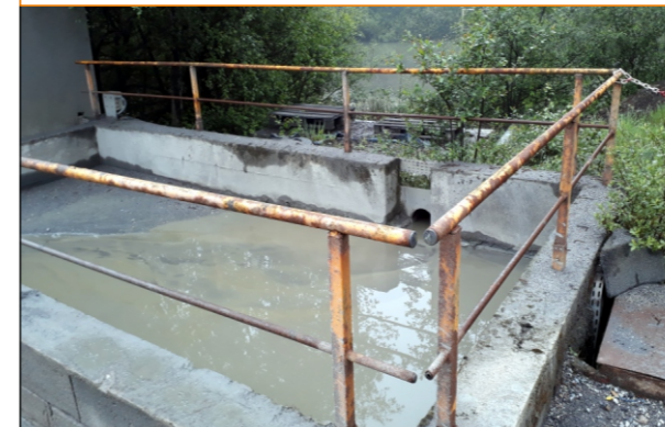
Débourbeur déshuileur (Bassin Richier)
